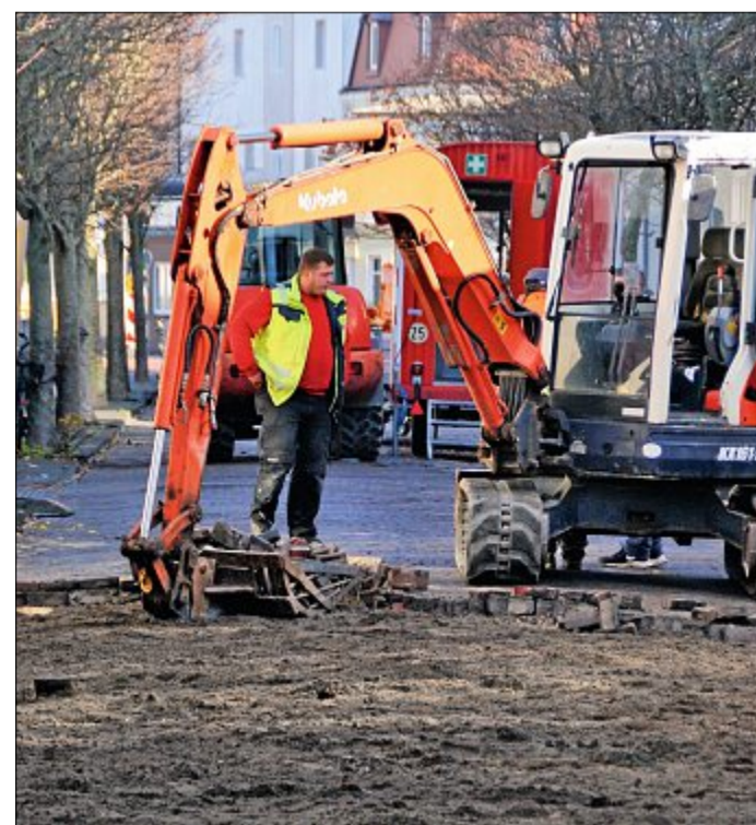
Vorsichtig werden die einzelnen Steine der Deckschicht mit einer speziellen Baggerschaufel entfernt. FOTO: BOHDE
